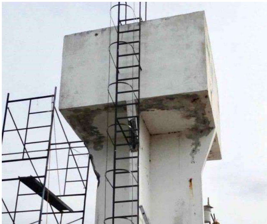
Figura 22. Tanque de almacenamiento de agua potable en un establecimiento de salud
