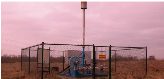
Dégazage d'une ancienne décharge à Schelle (Belgique) ©Société publique des déchets de la Région flamande
