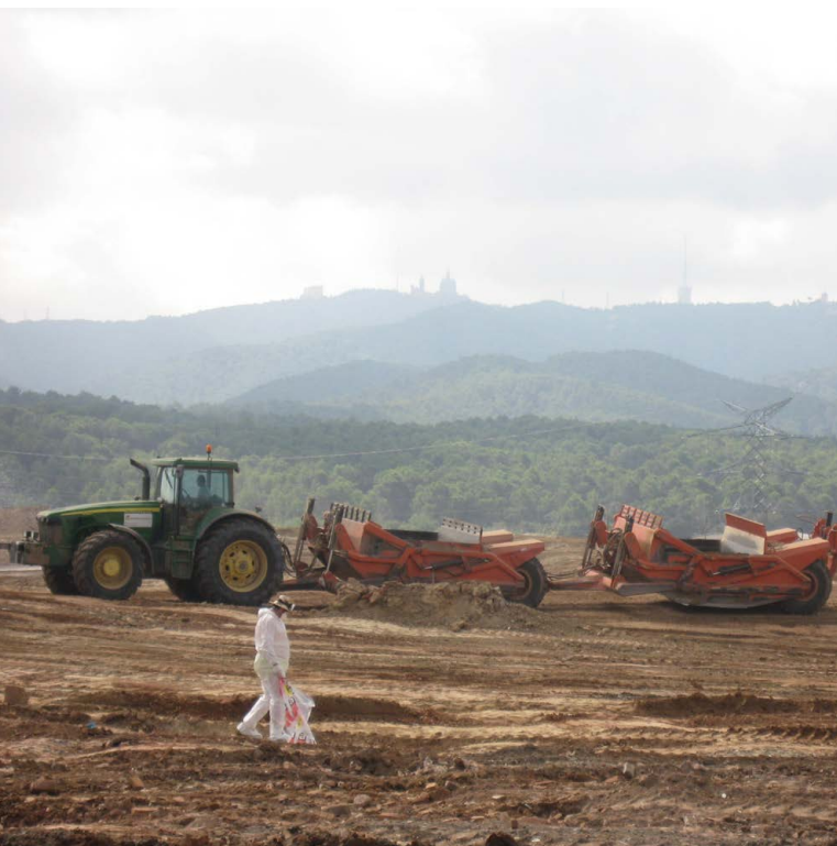
Sanierungsarbeiten und Abdichtung zur Vermeidung von Asbestexposition im Parc de l'Alba (Spanien) © Parc de l'Alba
