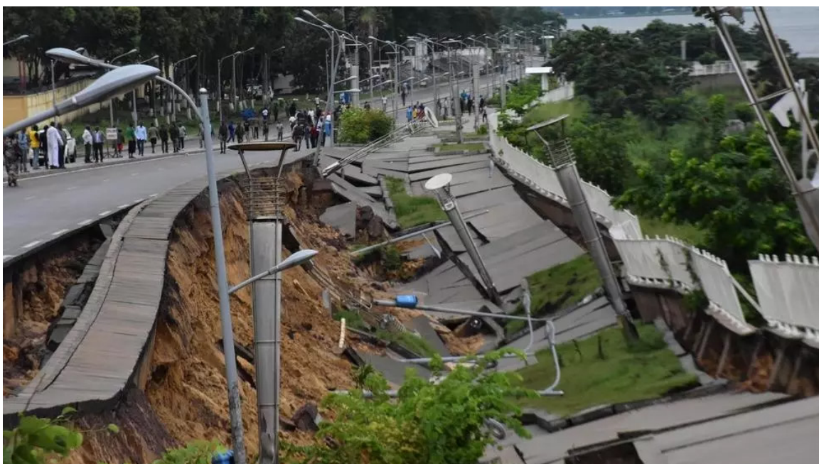
Figure 11. Collapse of part of La Corniche overlooking the Congo River in Brazzaville, 9 January 2020. Source: RFI/ Loïcia Martial, https://www.rfi.fr/fr/afrique/20200110-congo-b-eboulements-touchent-centre-ville-brazzaville
