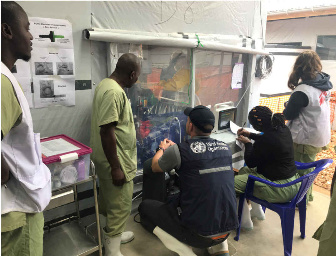
Figura 39. Ejemplo de superficie transparente con un concentrador de oxígeno y un monitor instalados fuera de la habitación de un paciente
