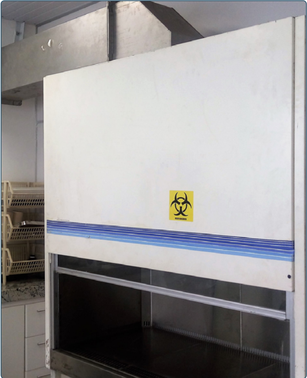
Figura 6. Capilla de extracción de gases
