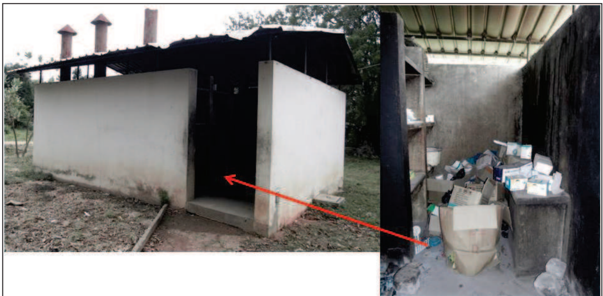
Photographies 3. Lieu de stockage des médicaments périmés au dépôt de zone de Tchaourou, Borgou-Alibori, 2012
