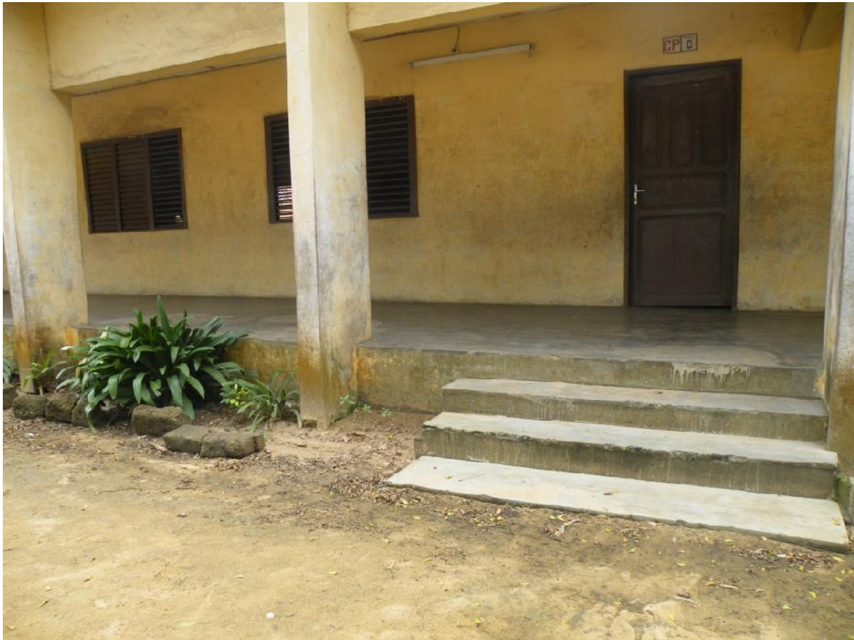
Photo : Difficulté d'accès aux salles de classe : entre sol humide et marches trop élevées
