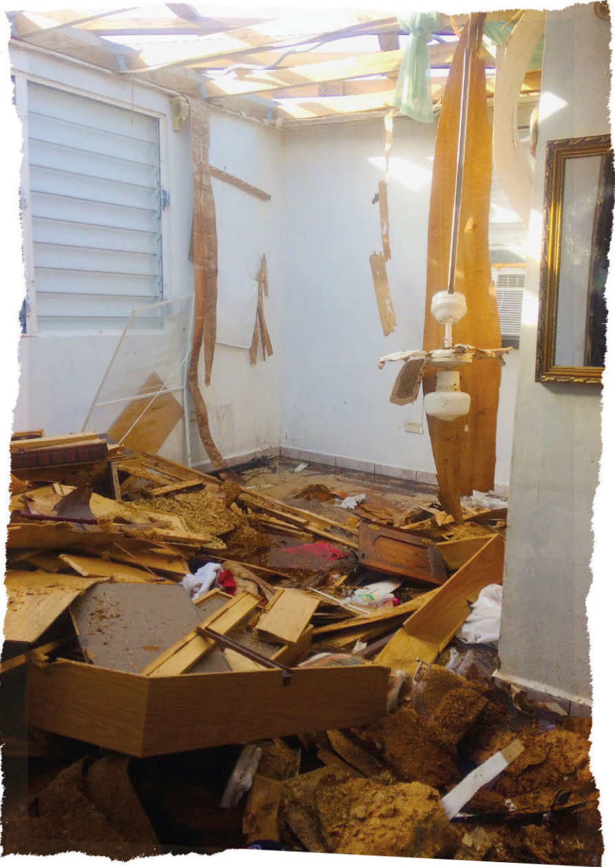
Interior de una vivienda dañada en Ingenio, Puerto Rico Fuente: Dra. Gemma Sou, octubre de 2017.
