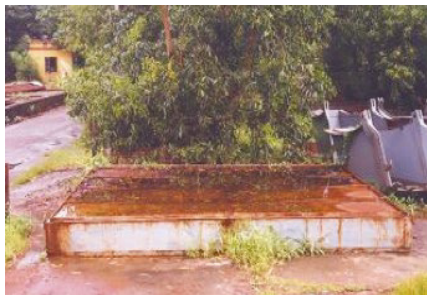
Figure 46. Plateforme métallique inondée © Ashwani Kumar
