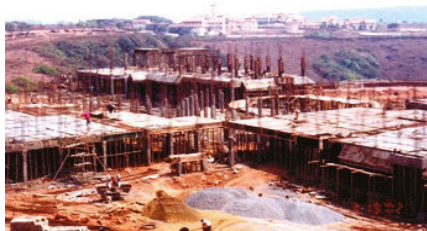
Figure 48. En ce point d'entrée, le chantier de construction représenté offre aux moustiques des possibilités considérables de prolifération © Ashwani Kumar
