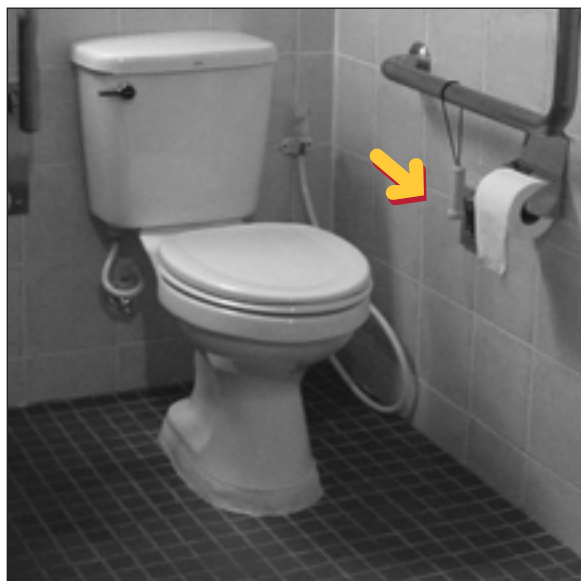
Fig. 35 : Système d'urgence pour les salles d'eau/toilettes.
