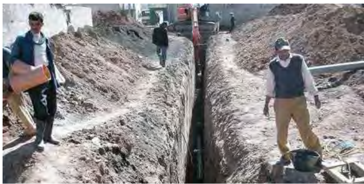
شبكة الصرف الصحي في بعض الأحياء من عواصم المحافظات
