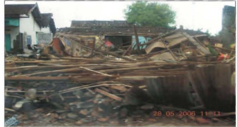
KET GAMBAR : kondisi rumah penduduk yang ambruk akibat gempa
