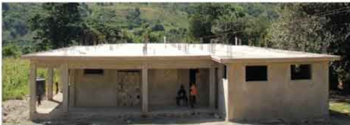
Construction d'une maternité au Centre de Santé de Cerca la Source - Financement Trésor Public (Investissement)
