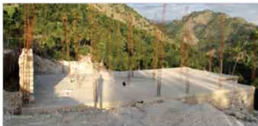
Construction du Centre de Santé de Bras de Gauche (Cotes de Fer) Financement: Trésor Public (Investissement)
