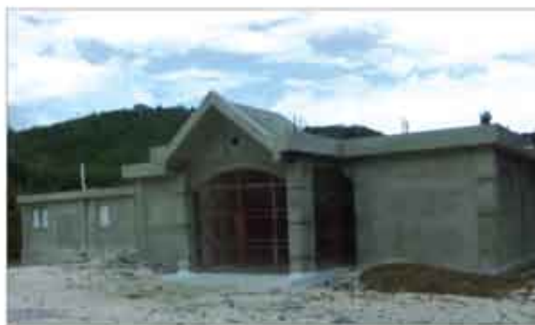
← Construction du Centre de Santé de Plaisance du Sud Financement: Trésor Public (Fonds communaux)
