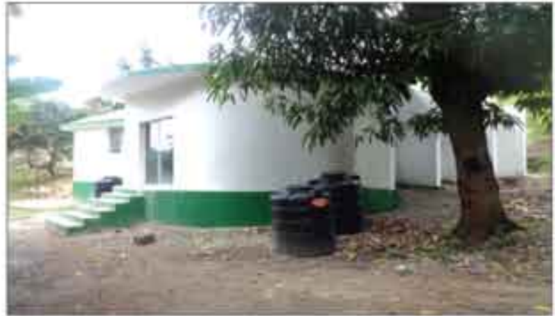
Construction du Centre de santé de Bariadelle (Dame Marie) - Financement Trésor Public (Fonds Communaux)
