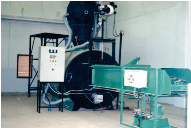
Figure 7. Incinérateur pyrolytique à haute température en chambre double
